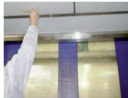
Hygienische Kontrolle der Decke im Kühlraum/Reiferaum (Kondensattropfen als Kontaminationsrisiko)
